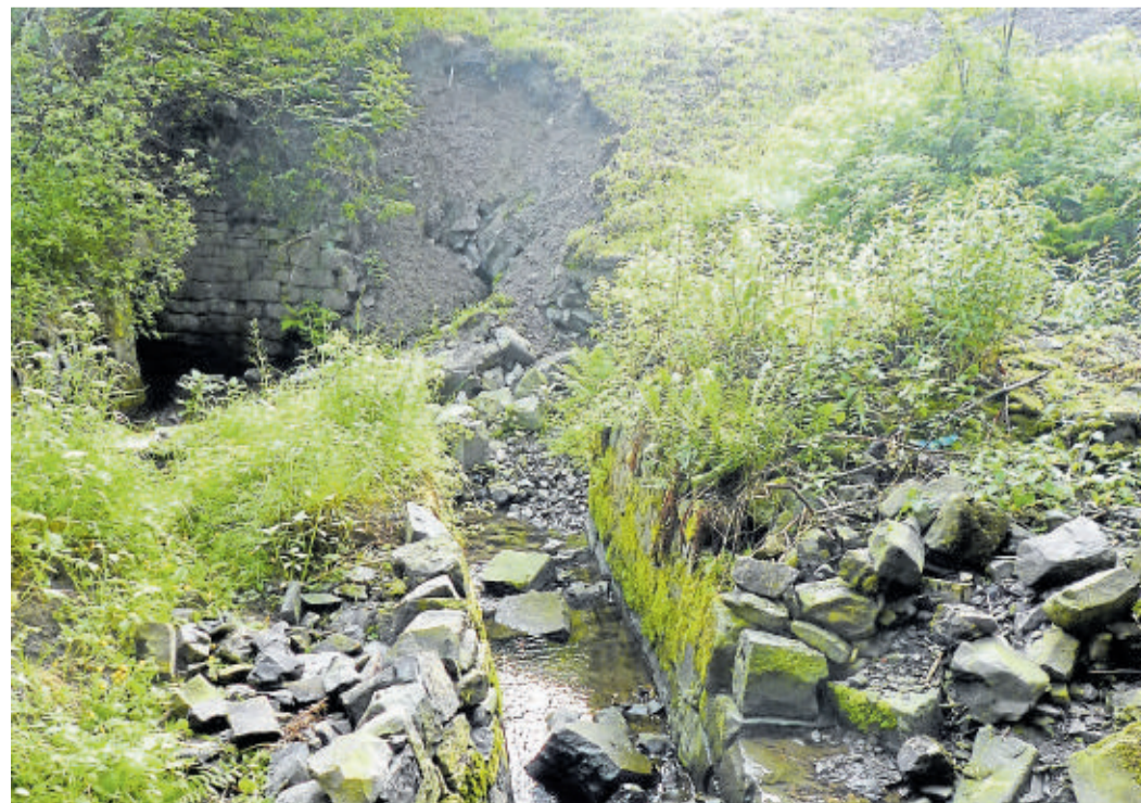
Bilddokument aus der „Roten Mappe“ 2024: Verschüttetes Mundloch an der „Widderwaage Großes Clausthal“. Foto: Privat
