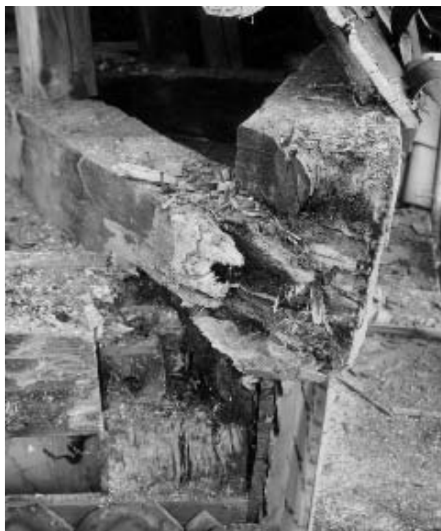
So sah es hinter den Verkleidungen aus: Schadensbefund während der Sanierung des Duderstädter Rathauses. Foto: Stadt Duderstadt
